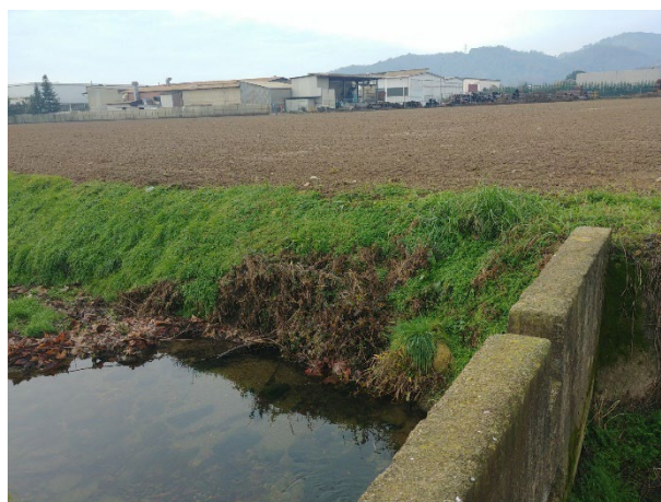
Fotografia 2: Particolare partitore su ramo ovest
